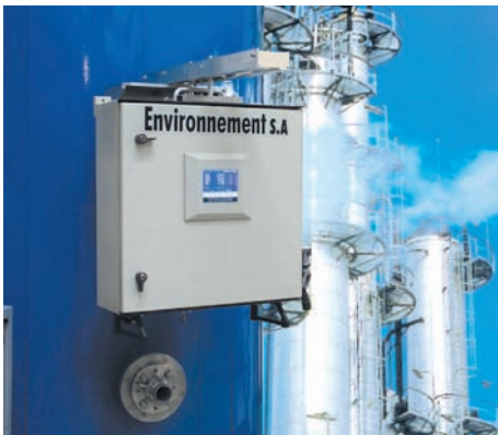
Installation direkt am Schornstein
